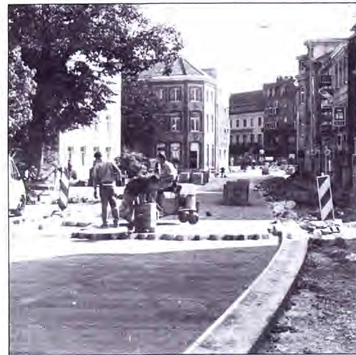
200 Quadratmeter Pflaster verlegen die flämischen Arbeiter pro Tag. Ein großer Teil der neuen Fahrbahn ist bereits fertiggestellt.
